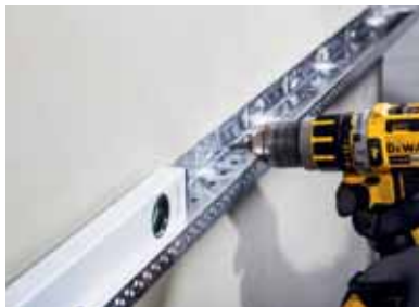
Слика 2 Након процеса поравњавања, Teknosistem цокла (Socle) профили се монтирају помоћу зидних прикључака.
