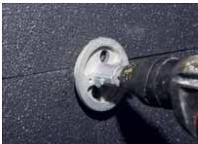
Слика 1 Потребно је направити удубљење употребом апарата да би се целосно поставила глава зидног прикључка и спречило задебљање.
